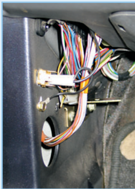
Fußraum: Ist es hier feucht, droht der Steuergerät-Exitus
